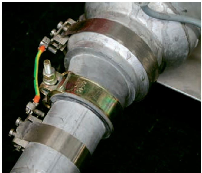
Abbildung 16 Gut geerdete Rohrverbindung zum Transport synthetischer Kieselsäuren
