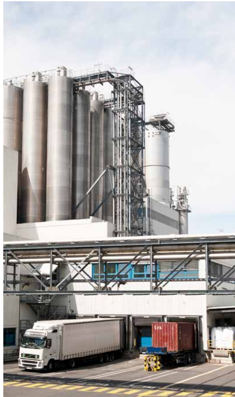
Abbildung 4 Siloanlage und Versandbereich im Werk Wesseling
